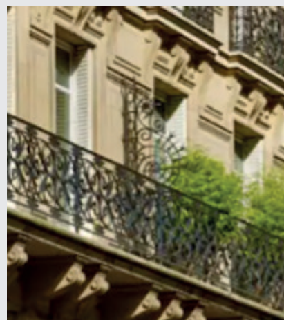
Séparation d'un balcon filant Haussmannien avec des artichauts
